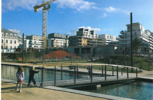
Les grues devraient bientôt définitivement quitter l'éco-quartier de la Caserne de Bonne. Les derniers travaux n'empêchent cependant pas les habitants de s'approprier les espaces communs, à commencer par les parcs publics.
